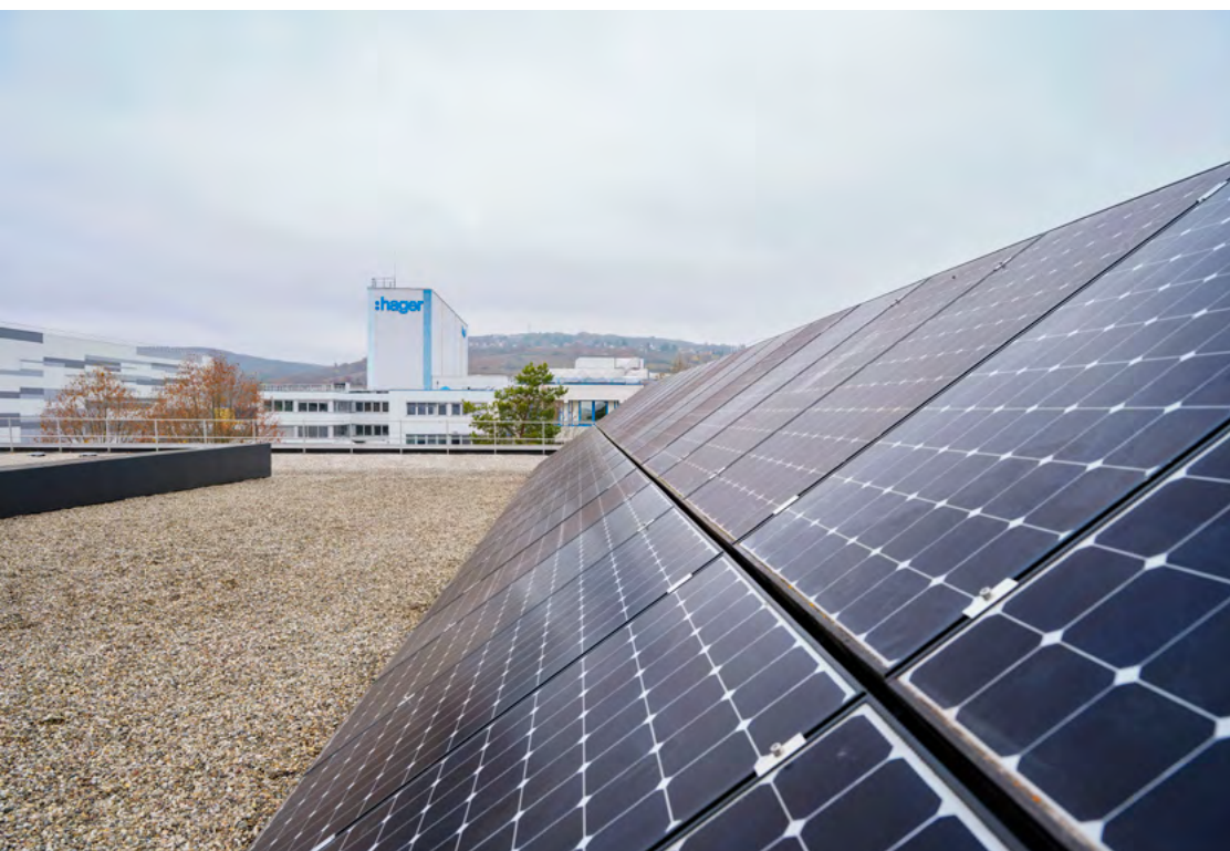
Cette photo a été prise sur le toit du Hager Forum à Obernai, en France. Le Hager Forum est avant tout un lieu de rencontre, qui joue aussi un rôle de catalyseur pour le développement de Hager Group. Le toit est équipé de 400 panneaux photovoltaïques qui transforment l'énergie solaire en énergie électrique. Ils couvrent 40 % des besoins en consommation d'énergie du Hager Forum.
